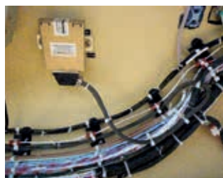
Dieser Low Power Bus Light Controller steuert die Lampen und ist in einem EC145 T2 an der hinteren, rechten Seitenwand montiert.
