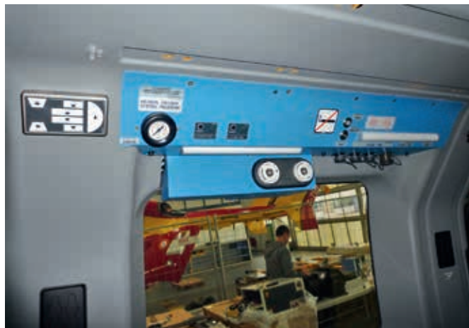
Dieses installierte Service Panel enthält unter anderem zwei Lampen, diverse Power Outlets und zwei KPH100 AC Bus Controller. Links daneben ist ein KVM105 Control Panel für die Beleuchtung installiert.
