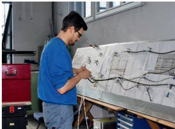
Nicolas Hütter bei der Vorbereitung eines Kabelbaumes, damit diese bei der Installation beim Kunden einfacher eingebaut werden können.
