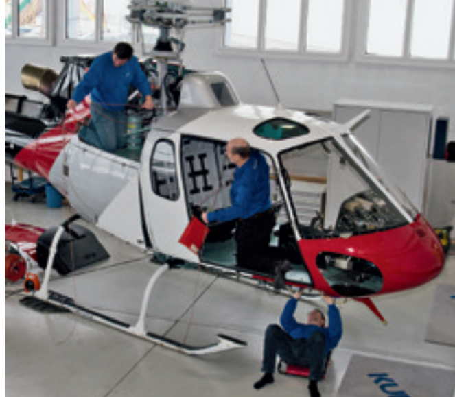
L'installation d'un nouveau TAS (Traffic Advisory System) nécessite la pose de nouveaux câbles et l'installation d'antennes supplémentaires.
