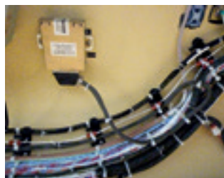
Ce Low Power Bus Light Controller gère les lampes et est installé à bord d'un EC145 T2 sur la paroi latérale arrière droite.
