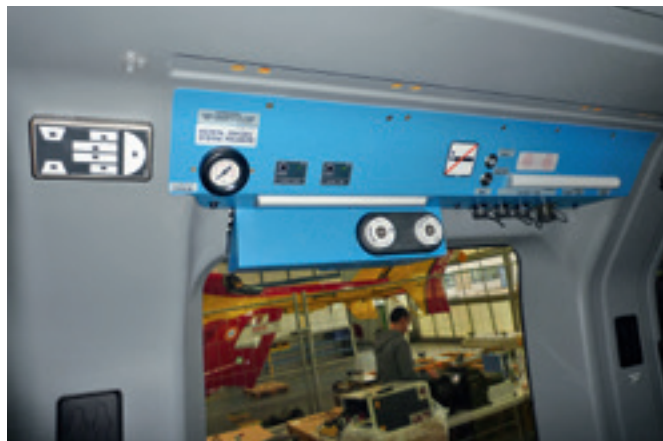
Ce panneau de service installé comprend entre autres deux lampes, une variété de prises de courant et deux KPH100 AC Bus Controller. À côté, un KVM105 Control Panel pour l'éclairage est installé à gauche.
